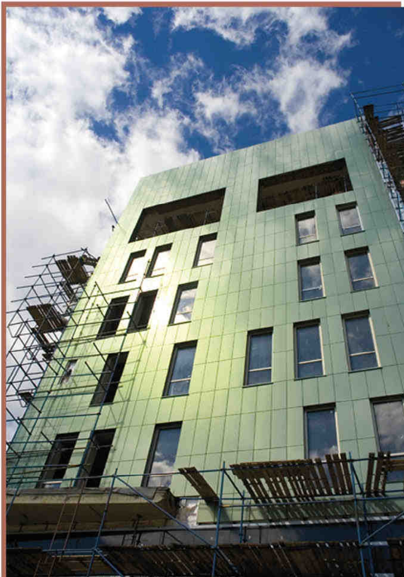
Рис. 5 Начало монтажа жилого дома по ул. Гоголя, г. Казань. Высота здания – 72 метра
