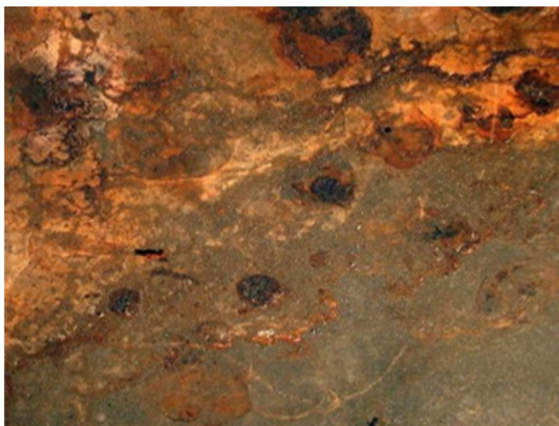
Фото 2. Резервуар, емкостью 40 м 3 , для хранения едких жидкостей. Видны следы коррозии металлических листов.
