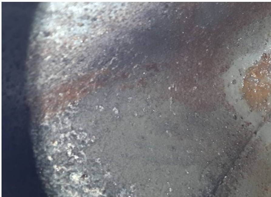
Фото 3. Резервуар, емкостью 40 м 3 , для хранения едких жидкостей. Внутренняя поверхность. Видны участки поражения коррозией.
