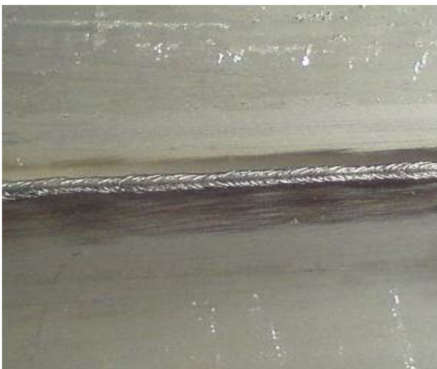
Фото 4. Резервуар, емкостью 40 м 3 , для хранения едких жидкостей. Внутренняя поверхность. Сварной шов.
